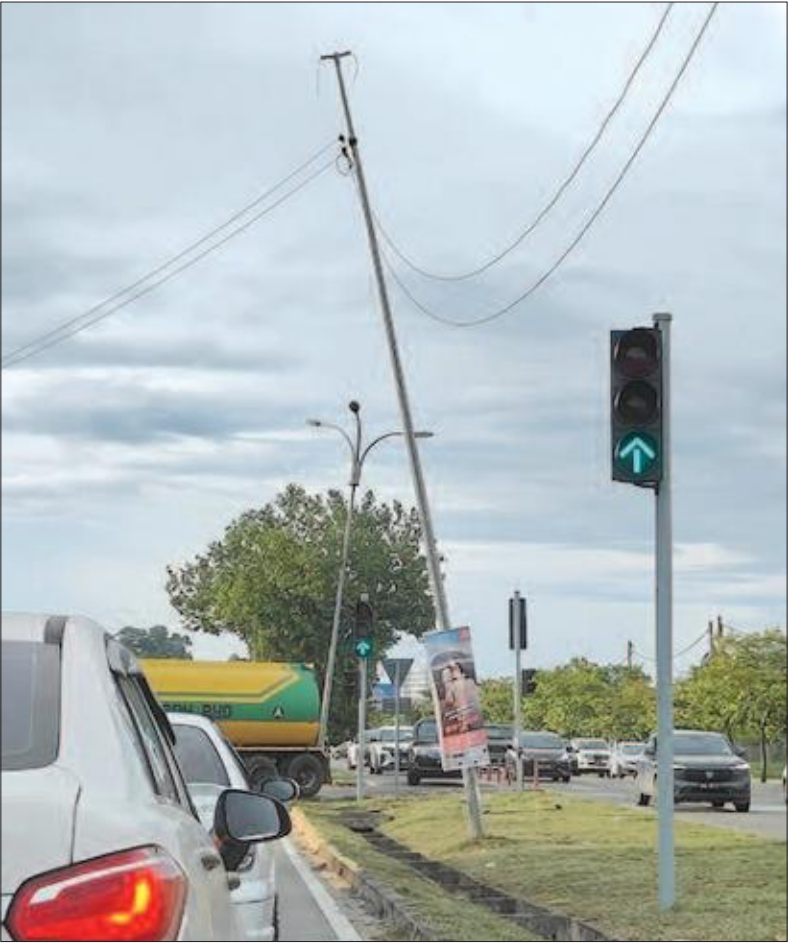
DBKK telah mengambil tindakan terhadap kemudahan lampu jalan yang condong di Jalan Lintas.
